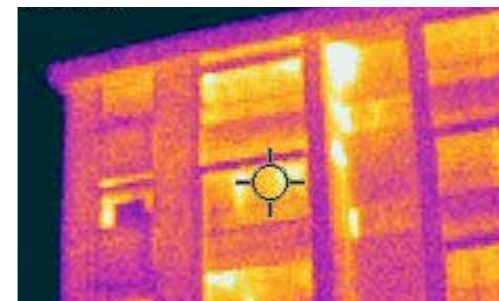
Bloque 1 Can Bassa. Fachada Oeste. Pérdidas en encuentro vertical. Fuente.- CENER
